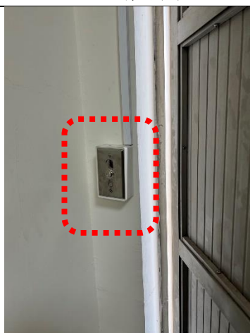
斷電按鈕安裝在門口附近
