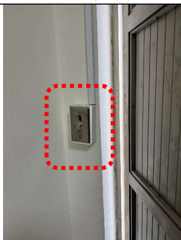
斷電按鈕安裝在門口附近
