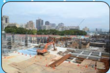
營建工地粉塵
