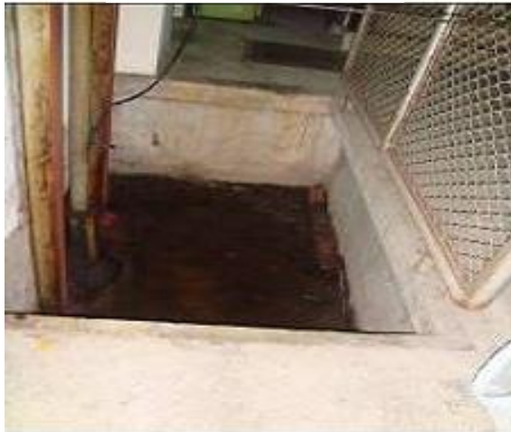
地下室之升降梯孔積水
