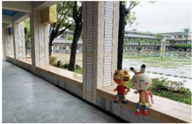
因前後棟高差銜接，提高 1F 地坪，故輔以木紋磚修飾搭配，形成有質感的休憩用座椅。
